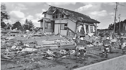
倒壊家屋からの救助(能登半島地震) (神奈川県HPから引用)
