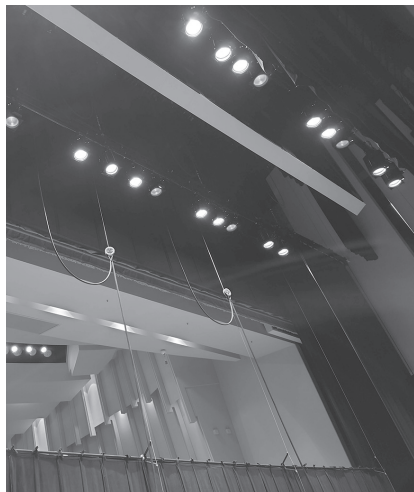
生涯学習センター舞台吊物設備
