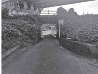
度々溢水する町道14号
