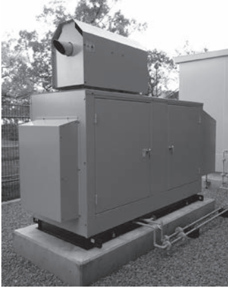
総合体育館 非常用発電装置
