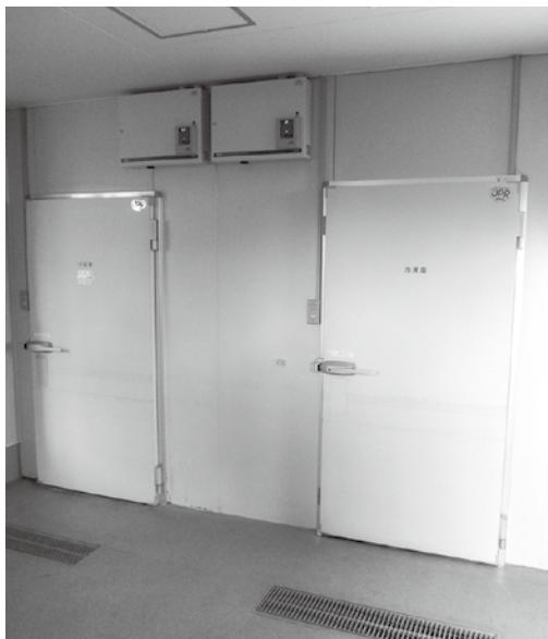
給食センター冷蔵庫・冷凍庫
