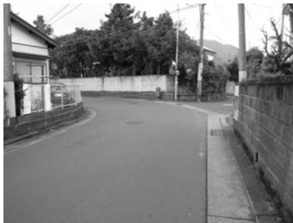
白線が消えてしまった町道
