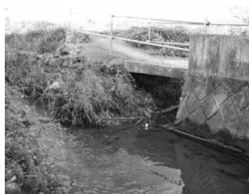
改修待たれる合流地点 (大川函渠)
