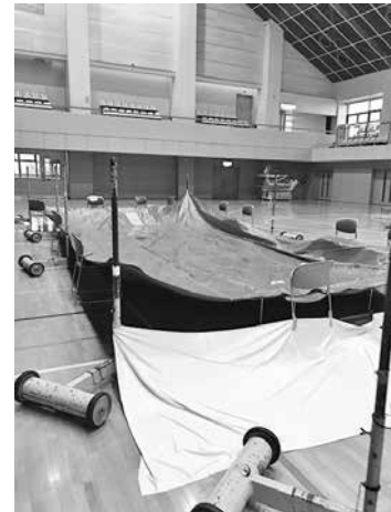
雨漏りしている避難所 (総合体育館)
