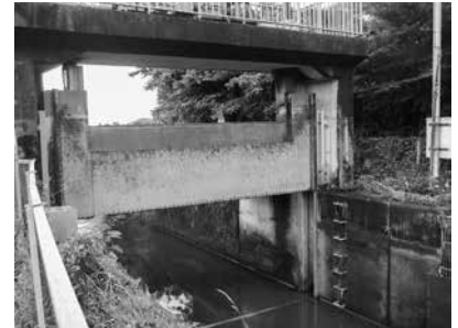
越水住民被害の元凶水門（上大井二方堰水門）
