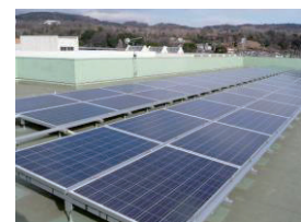
太陽光発電設備 （湘光中学校）
